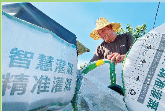
当前正值夏季农田管理关键时期,淮阳区积极推广高效节水灌溉技术,组织农民在田间铺设滴灌设施,科学应对高温天气,保障农作物稳产增收。图为7月4日,淮阳区王楼村农民正在田间铺设滴灌设施。
